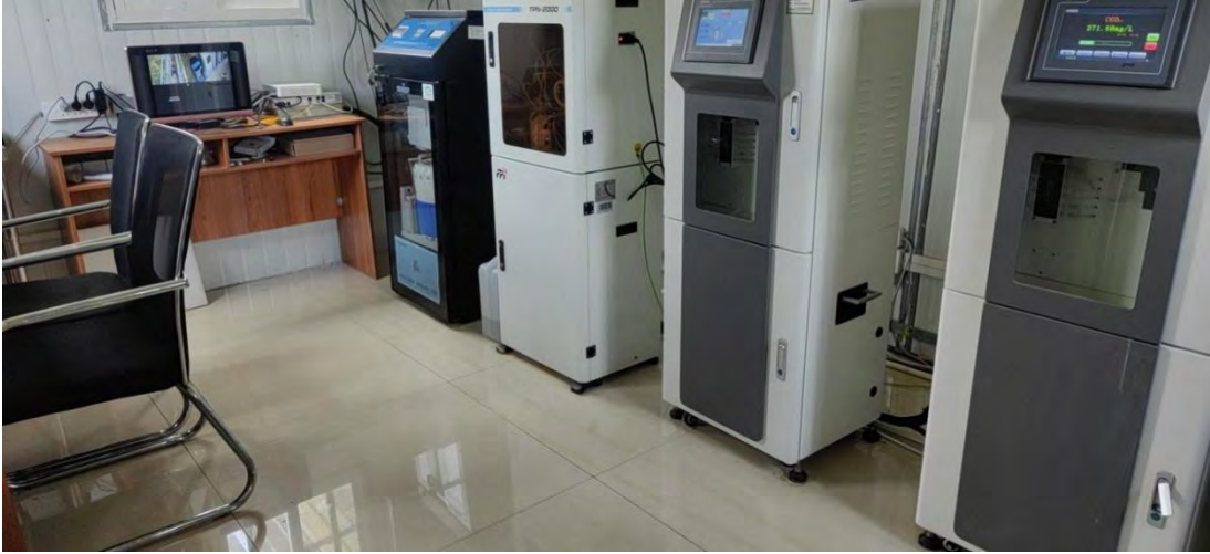
废水在线监测装置
