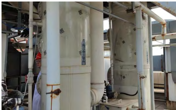
工艺废气两级碱喷淋塔
