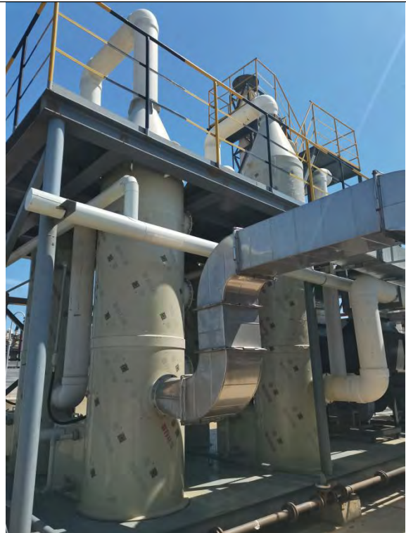
投料废气两级碱喷淋塔
