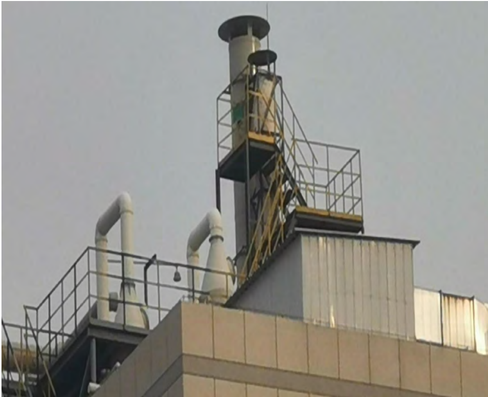
1#车间废气排放口标识牌及采样平台
