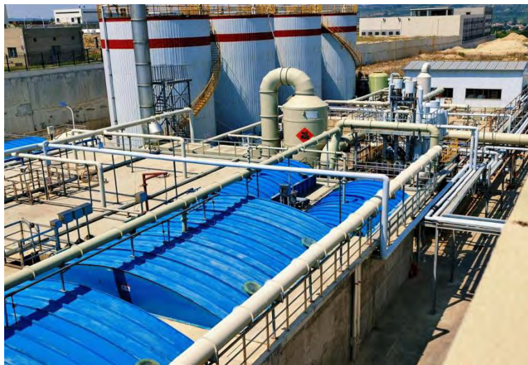
厂区污水处理站
