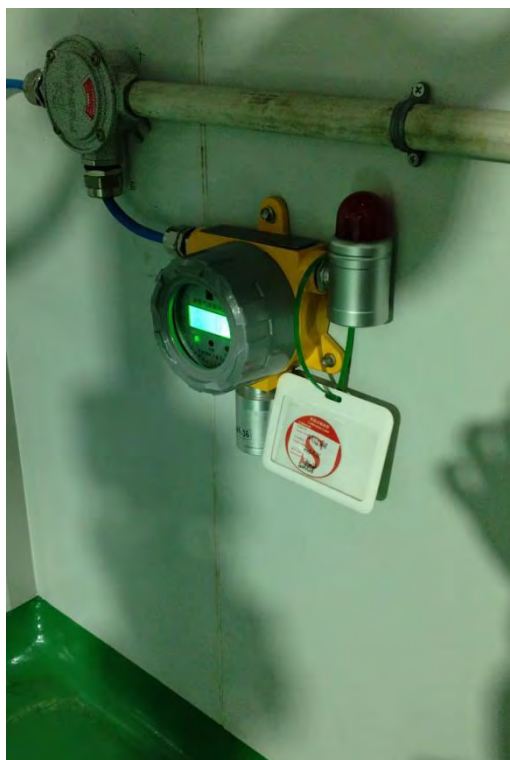
车间内可燃气体探测器
