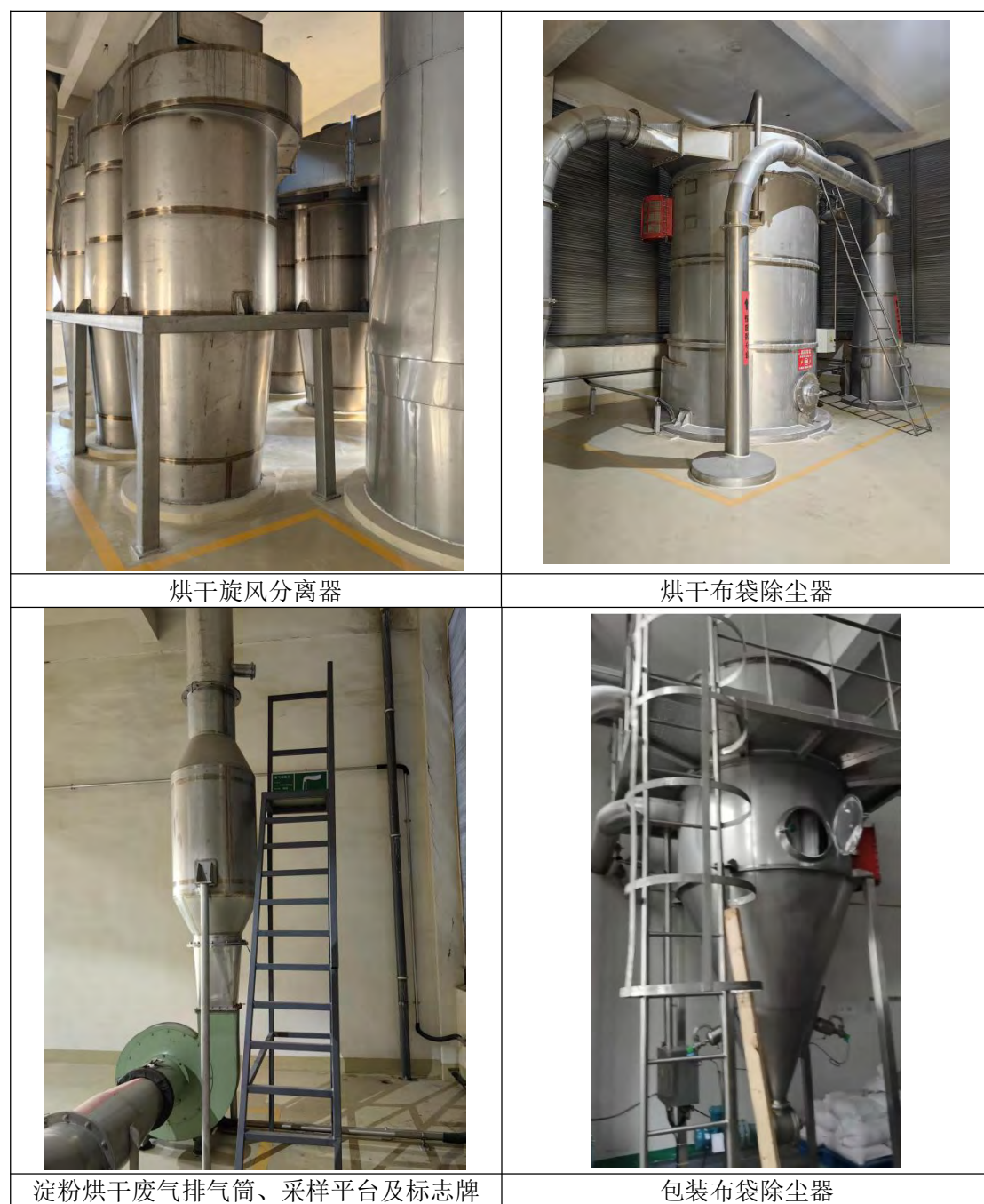
图 3-1 项目废气收集、治理设施及排气筒
