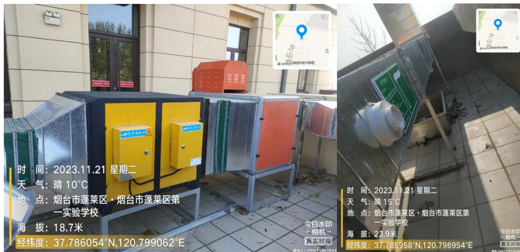
图 3-1 废气处理设施照片
