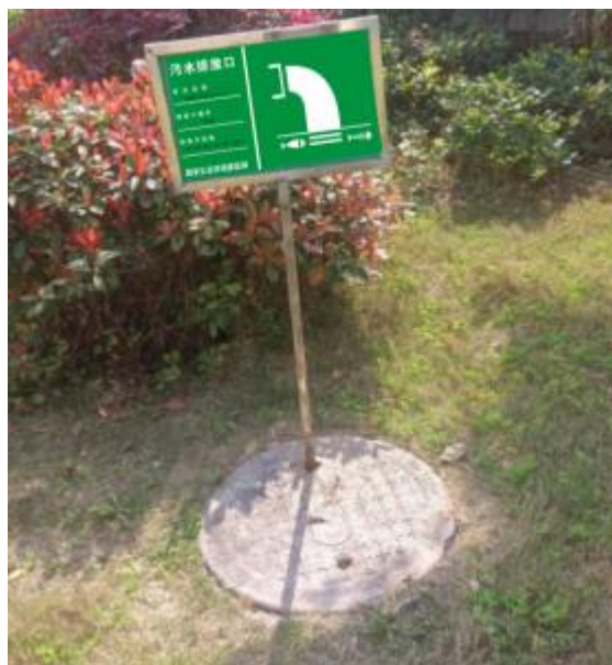
图 4.2-3 生活污水排放口及标志牌
