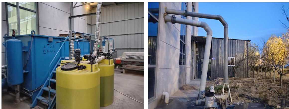
图 4.2-4 污水处理站照片
