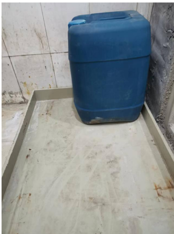
危废暂存间防渗托盘
