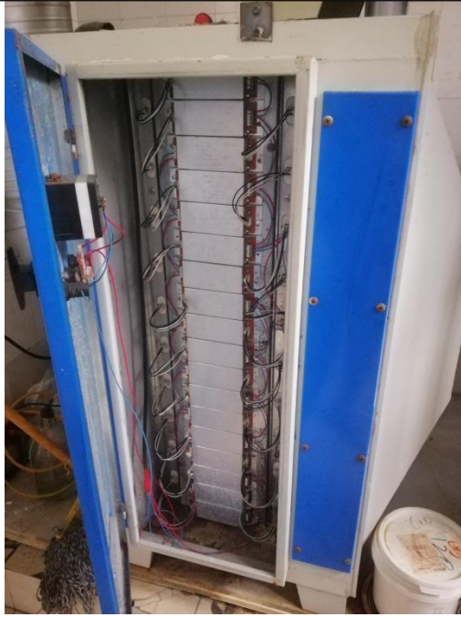
光氧活性炭复合废气处理设施
