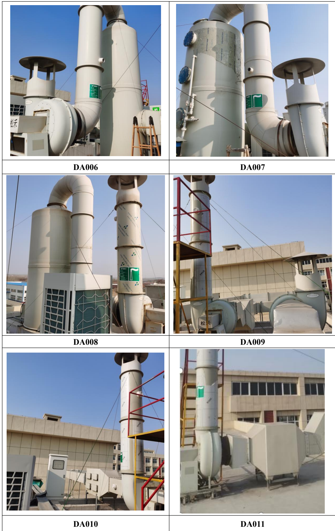
图 3-1 废气处理设施及排气筒
