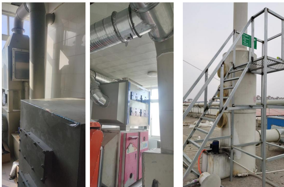
图 3-1 废气处理设施及排气筒
