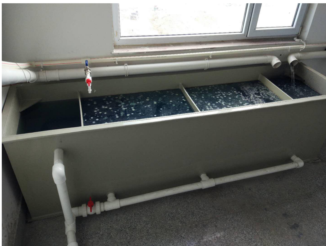
清洗废水中和池
