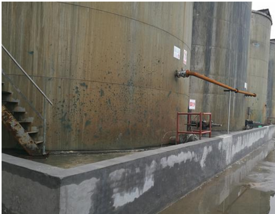
应急罐及围堰
