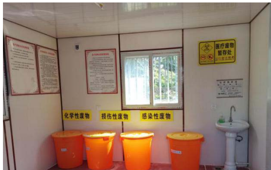
医疗废物暂存间
