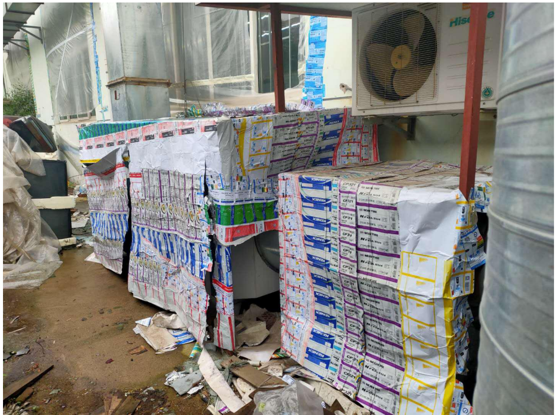
废气处理设施
