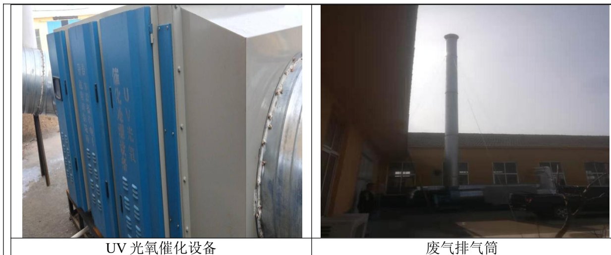
图 4-2 废气治理设施
