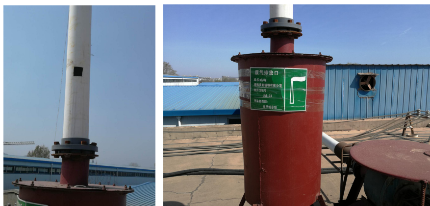
图 10-1-1 活性炭吸附设施取样口和排放口标识牌
