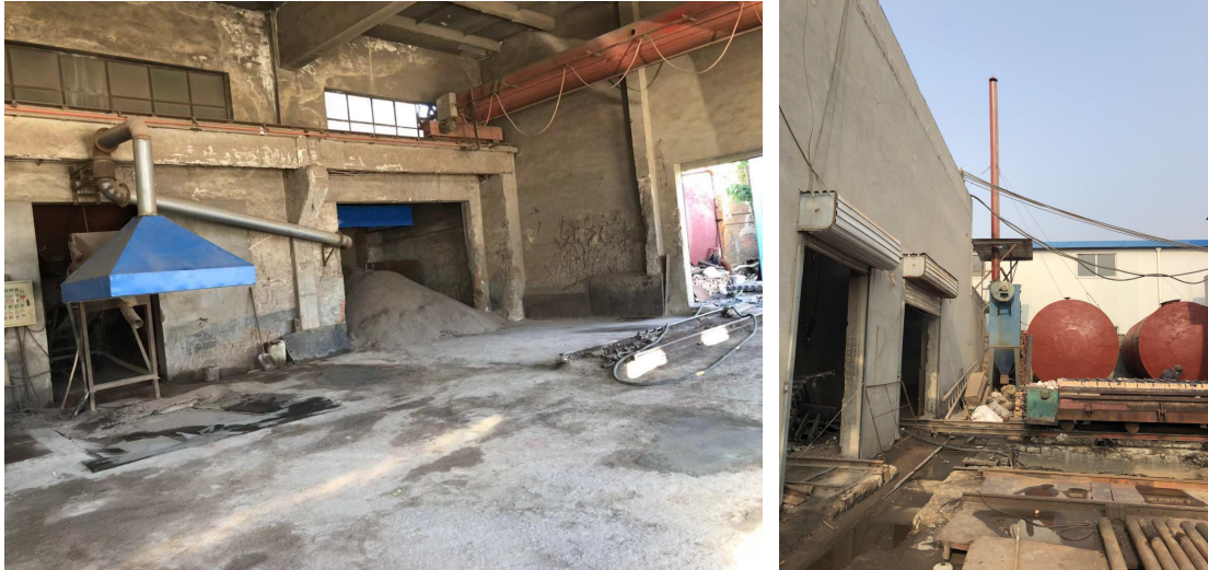
图 4-3 砂处理工序集气罩及布袋除尘设施+排气筒
