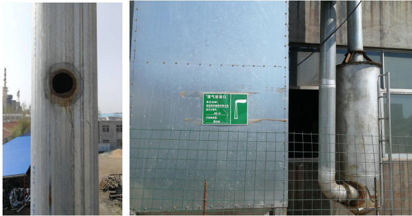
图 10-1-3 高压静电吸附+水浴除尘设施取样口和排放口标识牌
