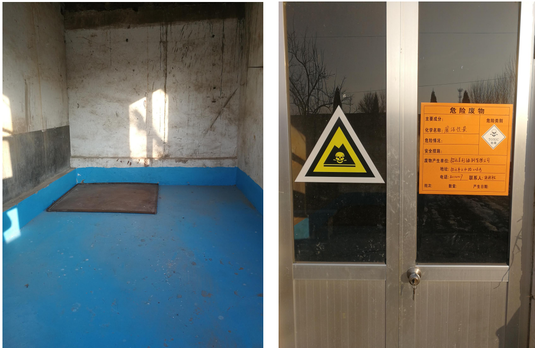
图 10-2 危险废物暂存间及标识牌
