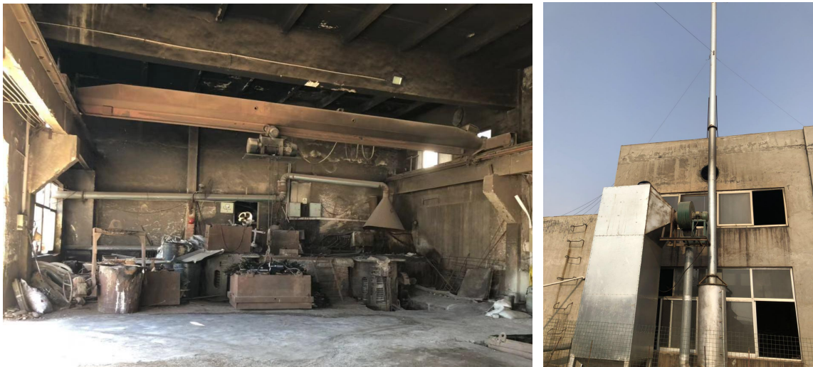
图 4-2 熔炼工序集气罩+高压静电吸附除尘设施+水浴式除尘设施+排气筒
