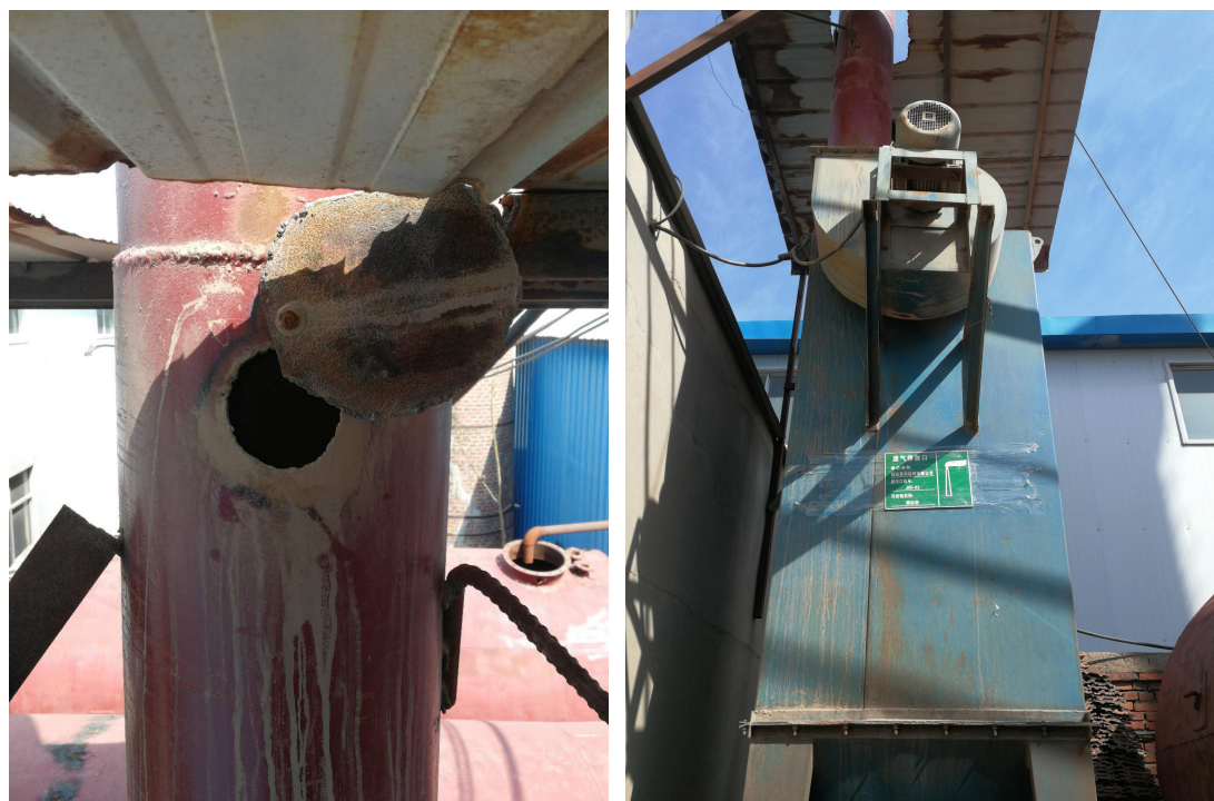
图 10-1-2 布袋除尘设施取样口和排放口标识牌
