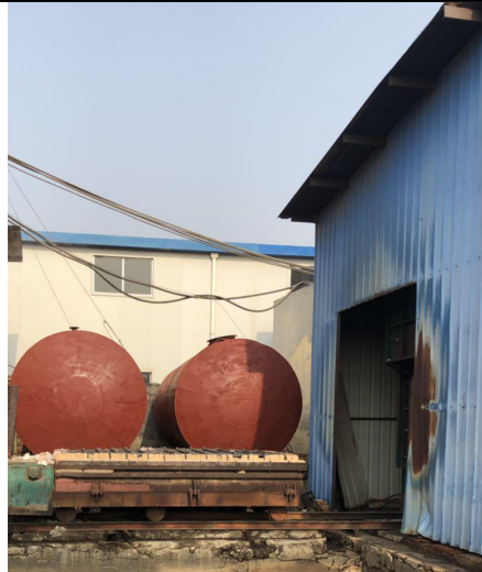
图 4-7 循环水储存罐
