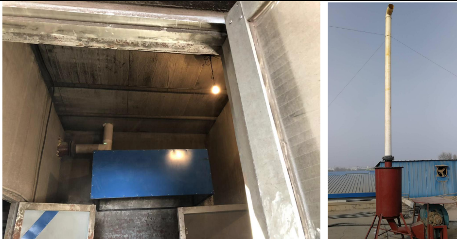
图 4-1 制模工序集气罩+活性炭吸附设施+排气筒
